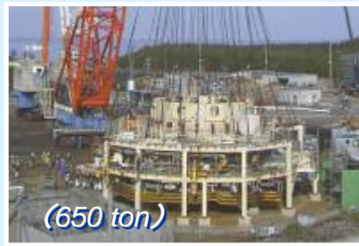
Upper Drywell Module
